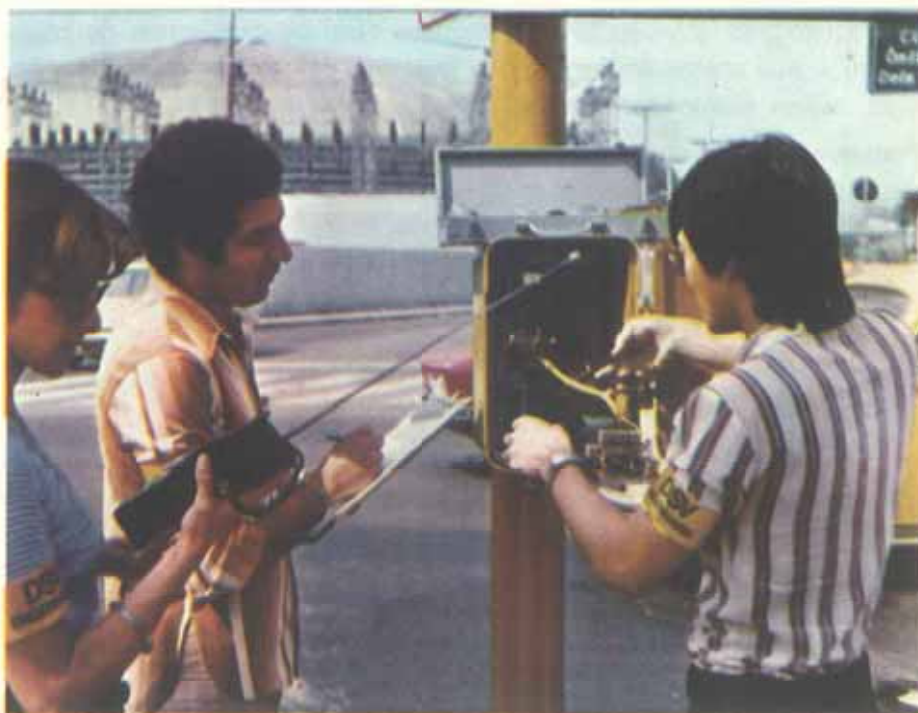
FIG. 14 — REGULAGEM DE CONTROLADOR AUTOMÁTICO ELETROMECAÂNICO SIMPLES.
