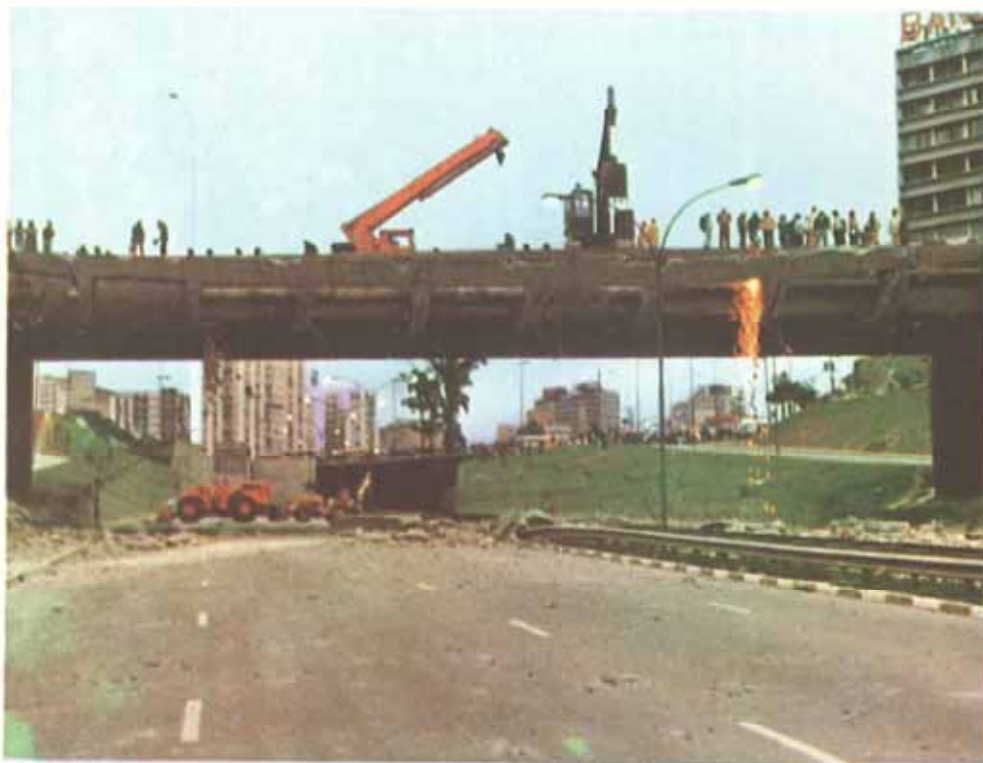
FIG. 29 — DESABAMENTO DO VIADUTO PAFAISSO.
